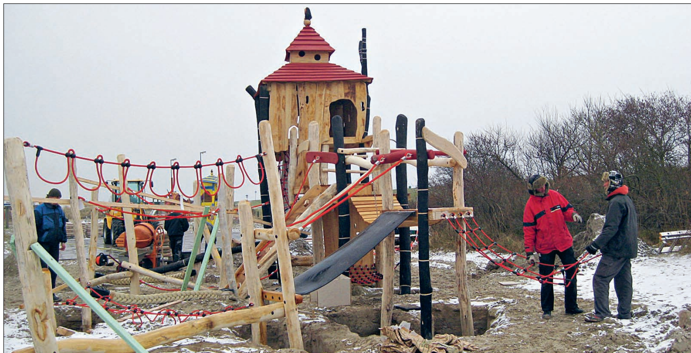
Mitarbeiter des Bauhofs der Gemeinde Juist erstellen ein Fundament für die neue Spielburg. FOTOS: REQUARDT-SCHOHAUS
